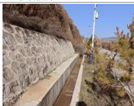
主体工程区截水沟
